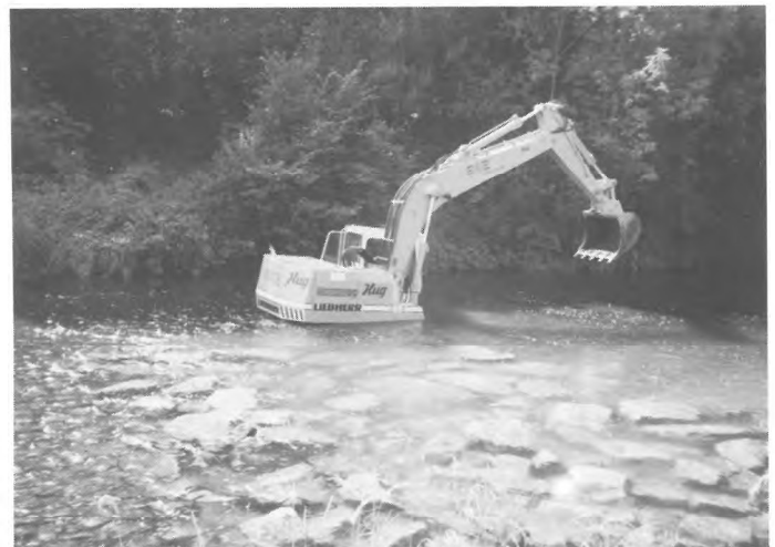
Beseitigung von Hochwasserschäden von Weihnachten 1991
